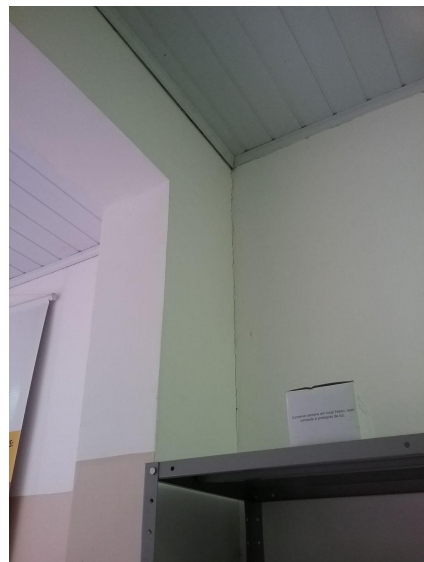
Rachaduras na parede e forro com espaço entre a parede
